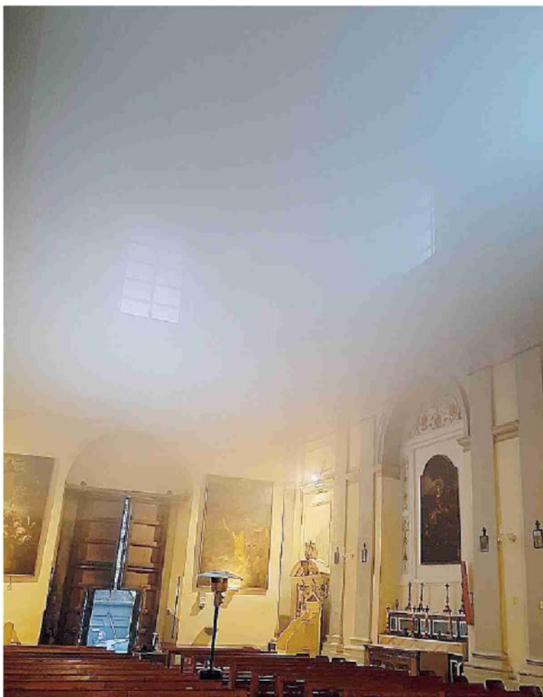
Sant'Agostino. L'interno della chiesa ieri dopo l'incendio
