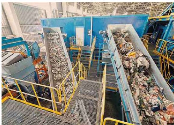
Il nodo infrastrutture. Un impianto di riciclaggio dei rifiuti
