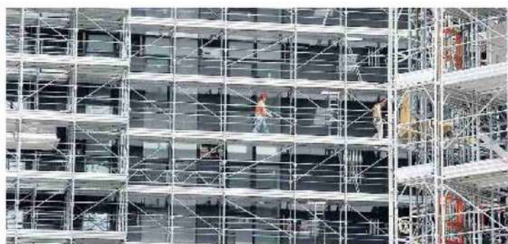
Operai al lavoro in un cantiere per l'efficienza energetica di un condominio
